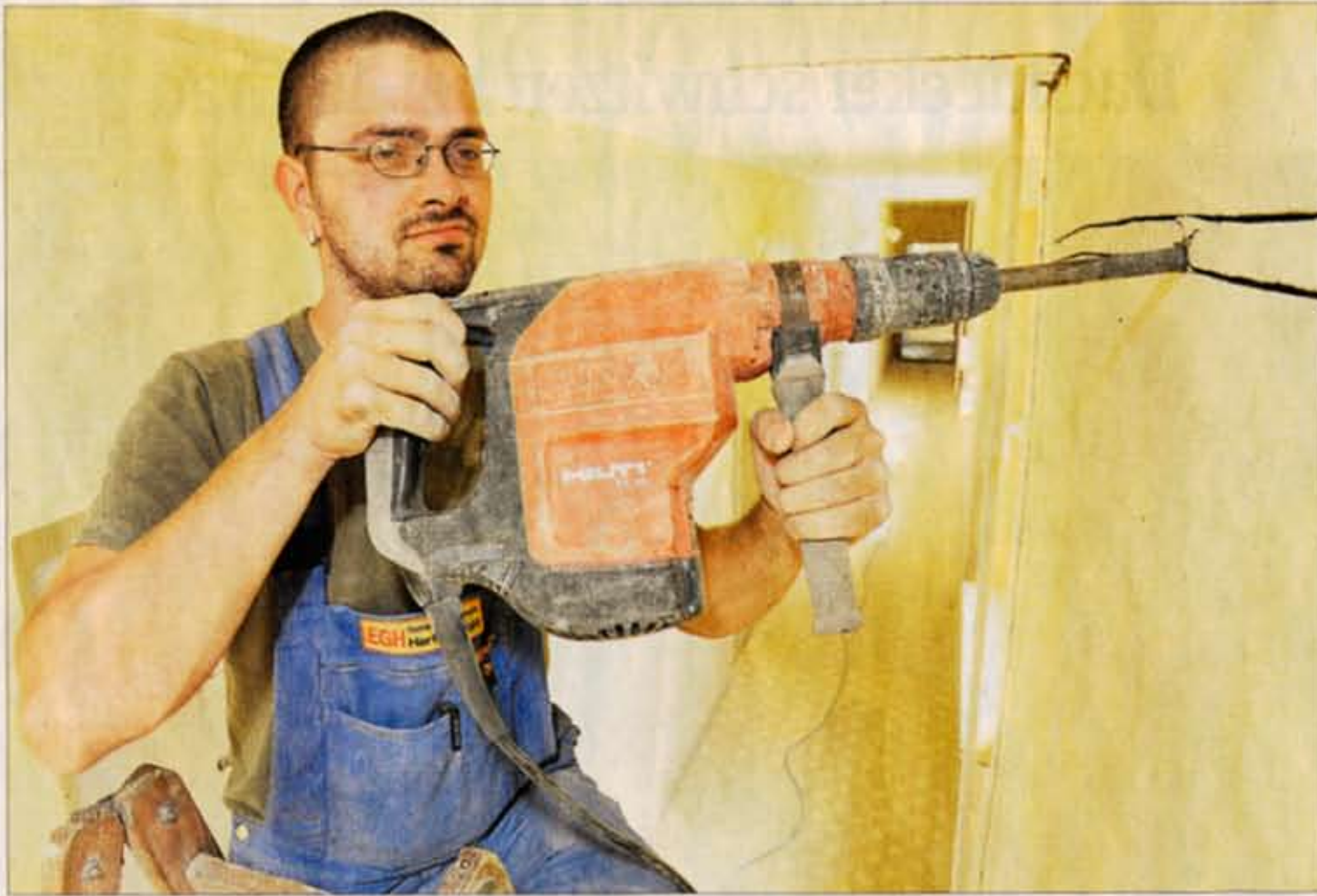
Michael Schütze von der Elektrogesellschaft Hartha legt neue Schächte für Elektroleitungen an. Gebaut wird im altersgerechten Wohnblock an der Straße der Jugend 75 in Hartha. Im Hausflur dieses Gebäudes hatte es am 19. April gebrannt. Jetzt muss unter anderem die Elektrik, die sich im Treppenhaus befand, verlegt werden. Erst dann können die Mieter wieder ihre Wohnungen beziehen. Foto: André Braun
